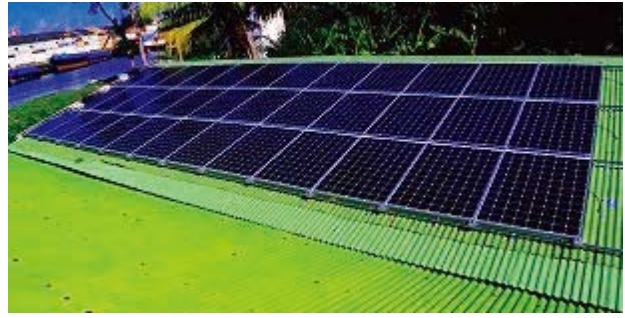
〔ソーラーパネル（出力：約 20kW/h）〕
