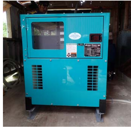
〔トノアス製氷施設：発電機の設置（架台付き）〕
