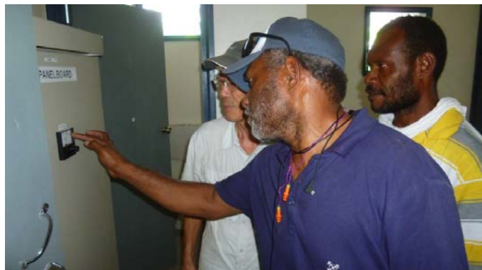
【モロベ州漁業局施設：カウンターパートからオペレーターへの配電盤の電圧確認の指導】
