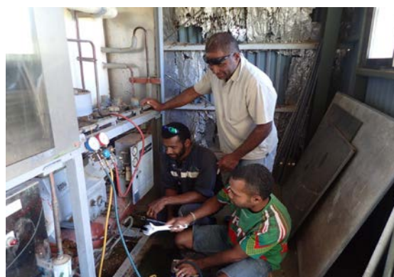
〔カウンターパートによる圧縮機のオイル交換〕
