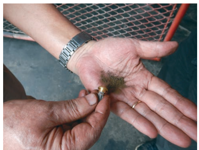
冷凍室の膨張弁に詰まる鉄粉（スケール）
