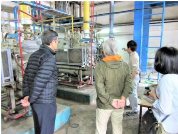
コンプレッサー
